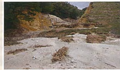
ため池堤体決壊
